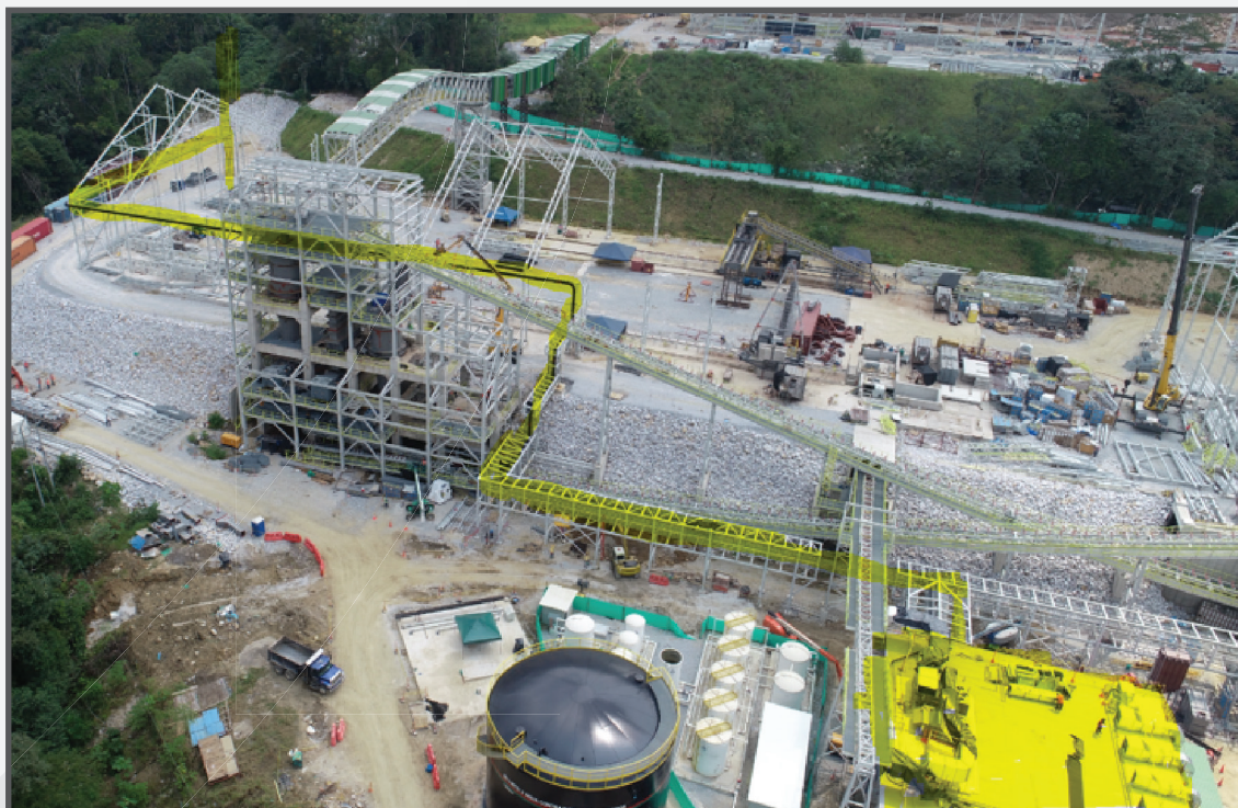
Imagen que resalta el recorrido de cable de media tensión para energización de la subestación 3P1, ubicada en la parte inferior derecha.
